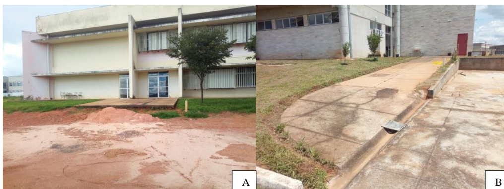
416 417 Figura 10 - Entradas inadequadas. (A) - Prédio A; (B) Prédio B
